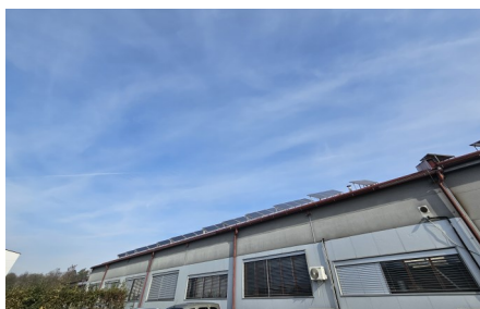
Монтирани соларни панели на покрива на едно от МСП в Птуй, Словения
